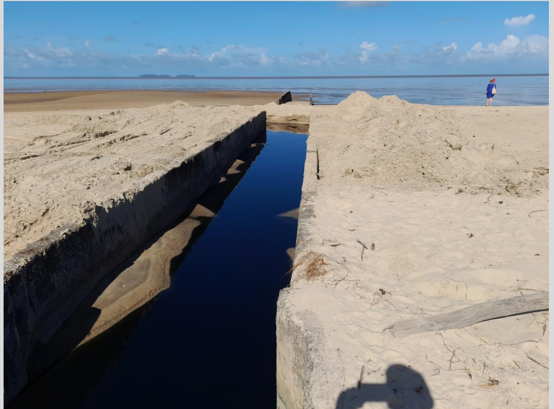
Ensablement De l'exutoire Kourou, Cerema 2023
