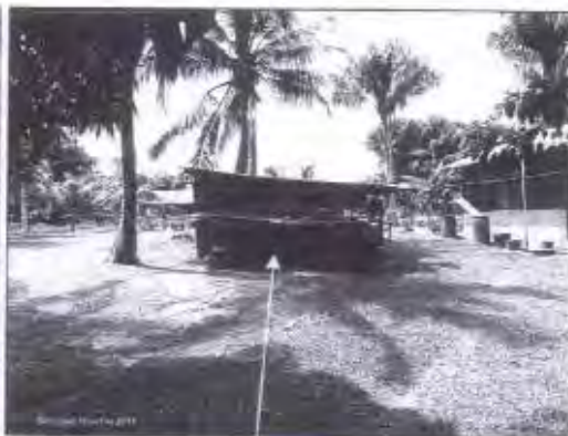
Le groupe électrogène. Le captage se trouve à 35 mètres, dans la zone d'appel.
